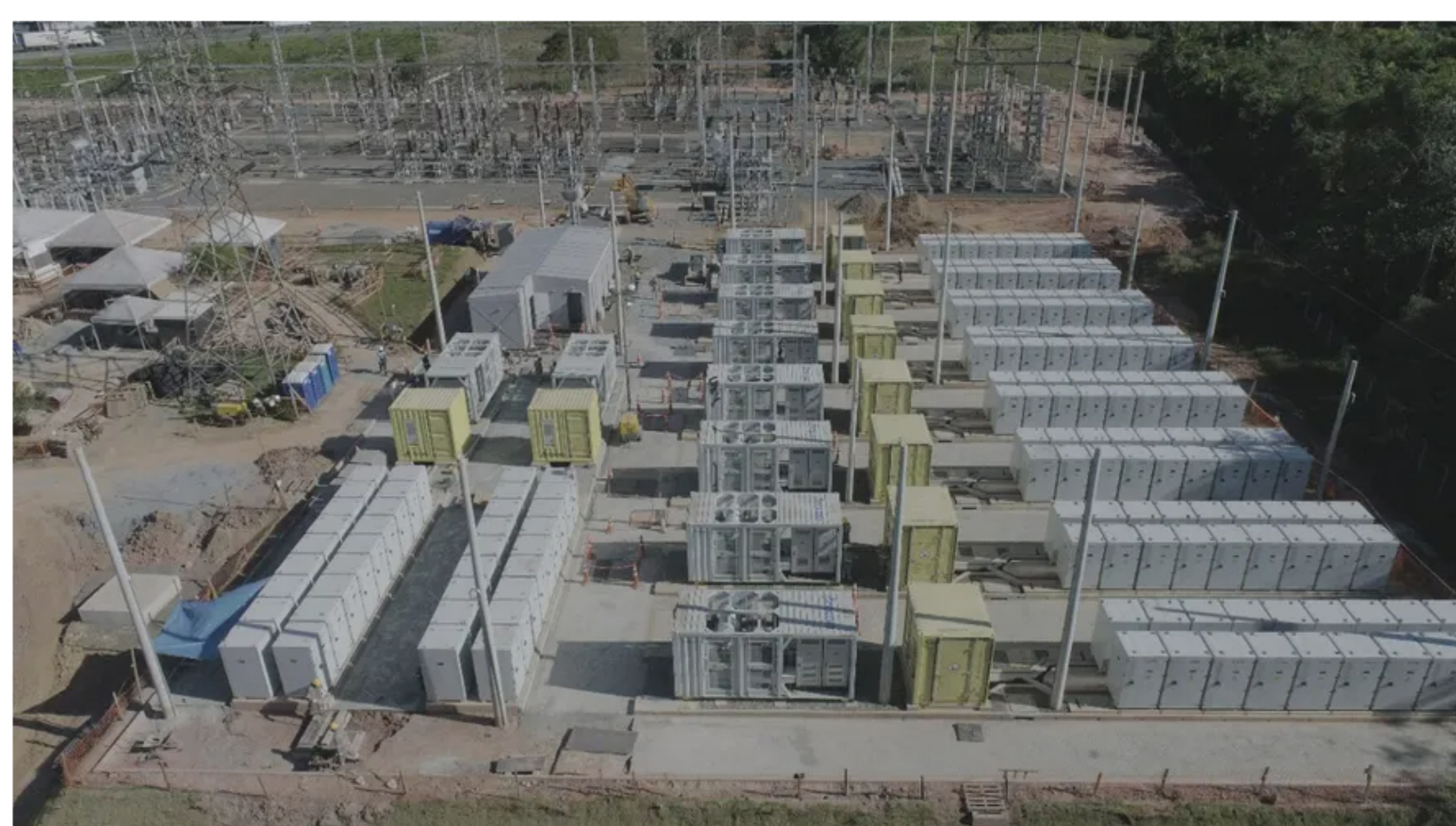
Sistema de baterias para armazenar energia da Isa Cteep, em Registro (SP) — Foto: Divulgação
